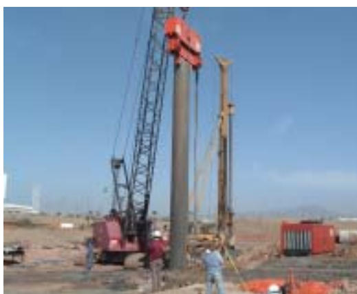
Fotografía 4. Aproximación del tubo al replanteo topográfico. Se puede observar el vibrador, que mantiene el tubo suspendido gracias a las mordazas hidráulicas.
