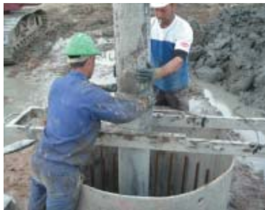
Fotografía 7. Acoplamiento de los sucesivos tubos para conducir el hormigón hasta el fondo.
