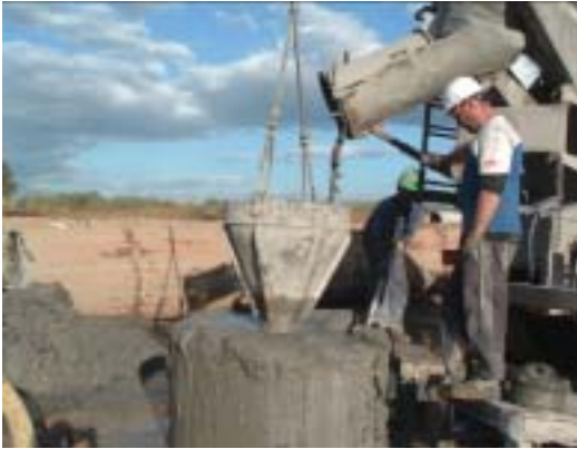
Fotografía 9. Se observa la salida de impurezas de la camisa. La cantidad de barras e impurezas depende en mayor medida a las clases de materiales que se encuentran en el fondo de la excavación, así como de la decantación de los materiales en suspensión.
