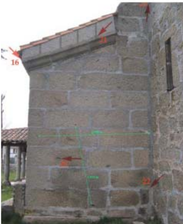
Figura 3. Distribución de los puntos de apoyo y medidas sobre la fachada FE3 de la iglesia
